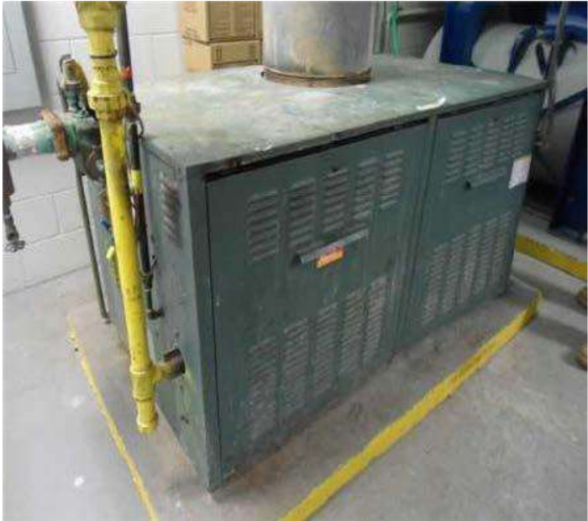
Pool Boiler 3.jpg
